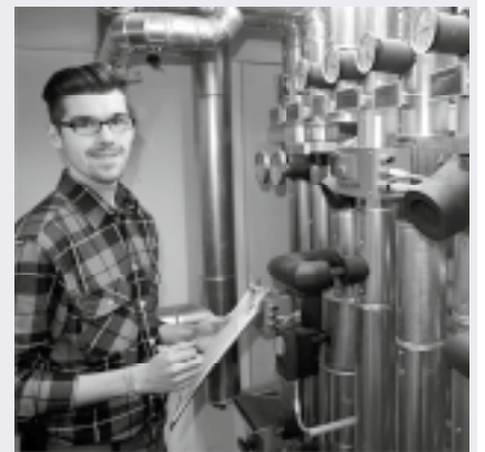
Mario Zöttler (19) an den Kältevertellern im Technikraum: Das Hauptgebäude der Akademie wird praktisch ohne Energieeinsatz nur mit Grundwasser gekühlt.
