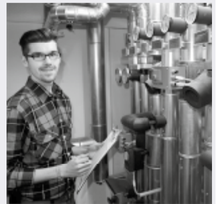
Mario Zöttler (19) an den Kältevertellern im Technikraum: Das Hauptgebäude der Akademie wird praktisch ohne Energieeinsatz nur mit Grundwasser gekühlt.
